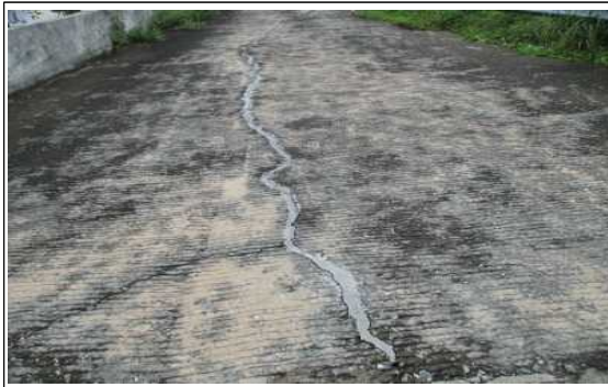
교면포장 A1측 접속도로 교면포장 보수부 재균열
