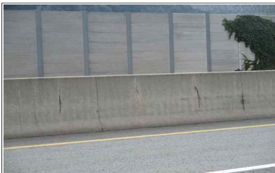
중분대 하행선 S1 균열부 백태
