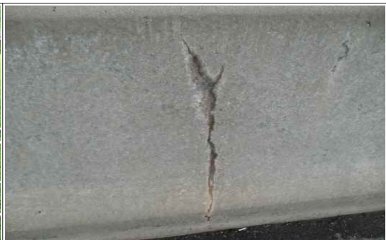
방호벽 상행선 S1 균열부 백태
