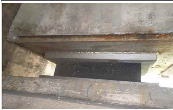
교량받침 상행선 A1 SH1 Plate 녹발생
