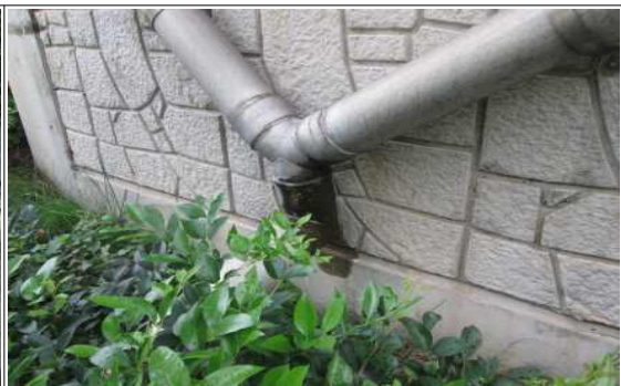
배수시설 A1 배수관 연결부 누수
