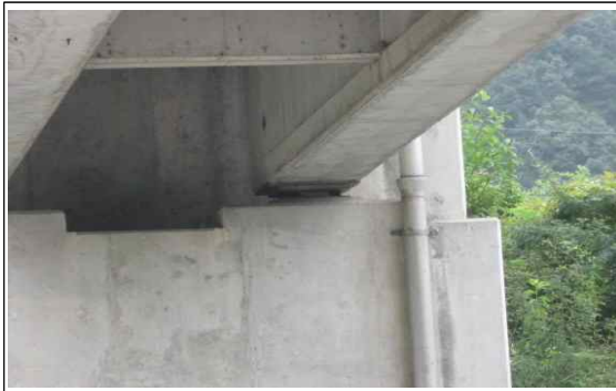
교량받침 A1 SH1 Plate 녹발생
