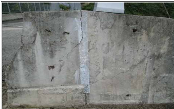
방호벽 A1측 접속도로 균열(폭 0.2~0.5mm)
