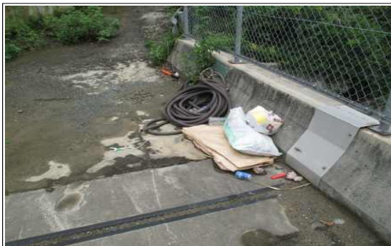
교면포장 A2측 접속도로 이물질퇴적
