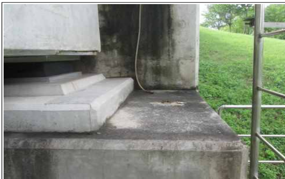
배수시설 하행선 S1(A1) 유도배수관 길이부족
