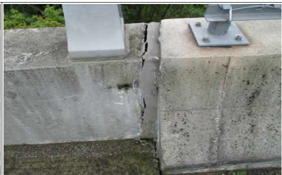
방호벽 A1측 접속도로 실란트 손상
