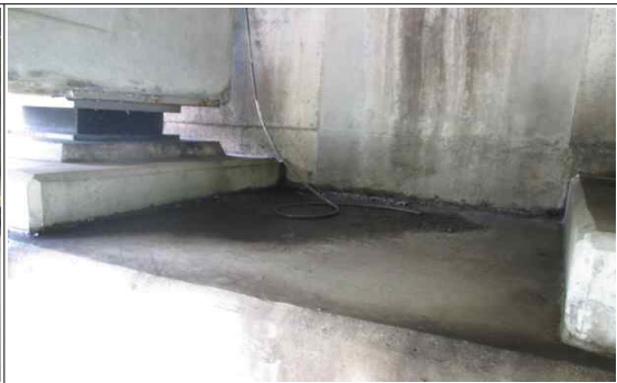
배수시설 상행선 S1(A1) 유도배수관 길이부족
