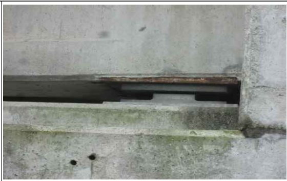
교량받침 A2 SH2 Plate 녹발생
