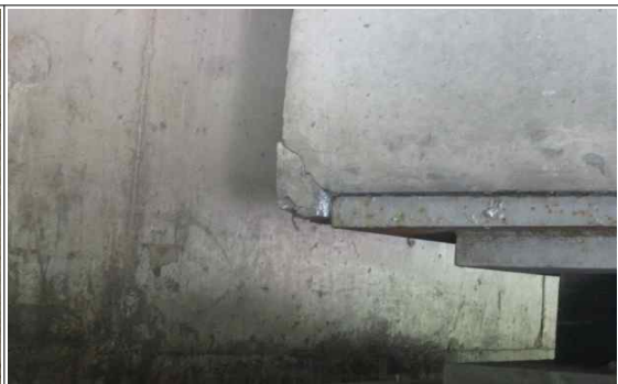
하행선 S1 G3 주형 Plate 매립부 콘크리트 손상
