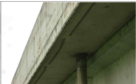
바닥판하면 하행선 S1 물끊기 홈 설치 미흡
