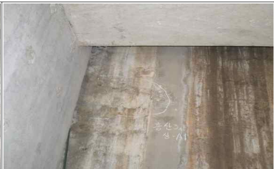
교대 상행선 A1 홍벽 콘크리트 들뜸
