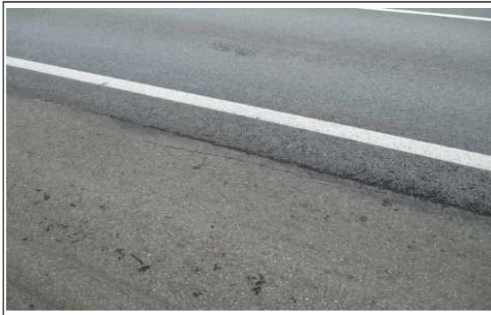
교면포장 상행선 S1 아스콘 패임
