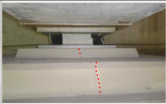
교량받침 상행선 A2 SH4 무수축물탈 및 받침콘크리트 균열
