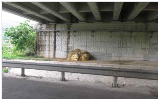
교대 상행선 A1 벽체 누수흔적
