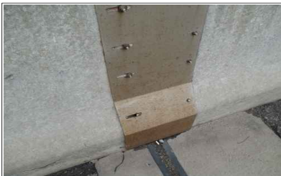
상행선 A1 차수판 앵커 탈락
