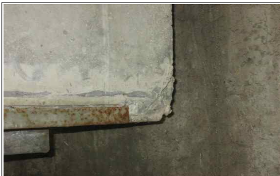
주형 상행선 S1 G4 Plate 매립부 콘크리트 손상
